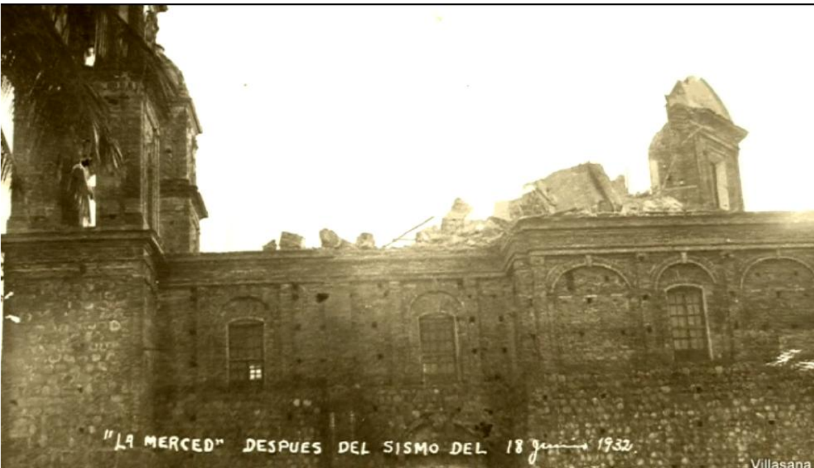
Figura 5. Daños causados por los sismo de Colima de 1932. La fotografía superior muestra algunos daños producidos por el tsunami del día 22 de abril. En la fotografía inferior se muestran los daños a estructuras en la Cd. de México producidos por el sismo del 18 de junio.
